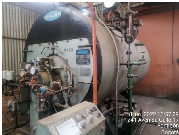
FOTOGRAFÍA No. 3. Caldera Colmaquinas de 80 BHP
