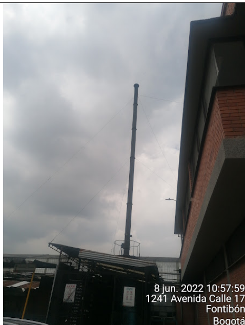
FOTOGRAFÍA No. 5. Ducto de la caldera
