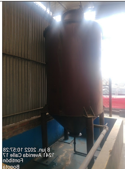
FOTOGRAFÍA No. 4. Tanque de ACPM
